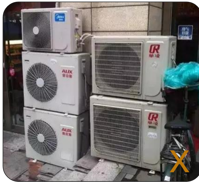
Instalación Incorrecta U.E. juntos, hay un sonido anormal.
