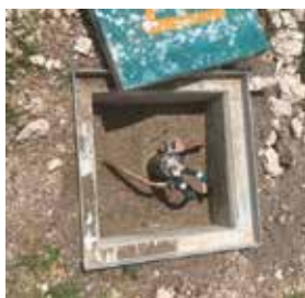
*Cableado de manera directa.
